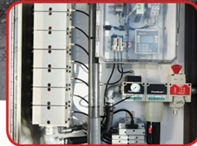
Panel de Control de Aire
