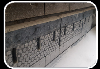
Revestimientos de Caucho-Cerámico siguen en operación después de 15 meses!
