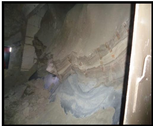
Foto de arriba: Taponamiento extremo debido a la falla del sistema de la competencia.
