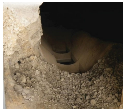
Antes: Piso obstruido en un chute clasificador subdimensionado.
